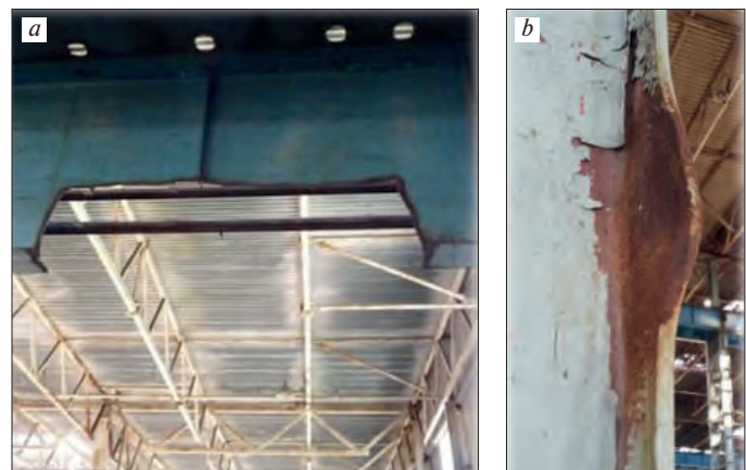
Рис. 3. Характерные повреждения, полученные стальными элементами при эксплуатации: a – вырез стенки, поперечного ребра и нижней полки подкрановой балки; b – механическое локальное повреждение колонны крановой эстакады Fig. 3. Typical damages received by steel elements during operation: a – cutout of the wall, transverse rib and lower flange of the crane beam; b – mechanical local damage to the crane trestle column
