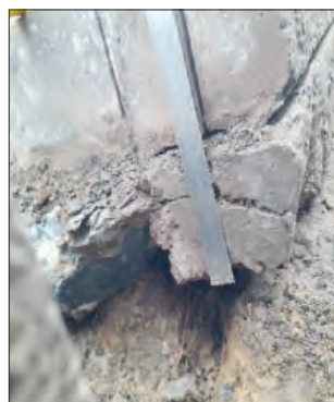
Рис. 3. Разрушение цементобетонного слоя дорожной одежды Fig. 3. Destruction of cement concrete layer of road pavement
