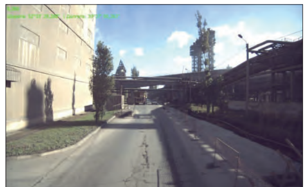
Рис. 4. Повреждения на поверхности асфальтобетонного покрытия Fig. 4. Damage on the surface of asphalt concrete pavement
